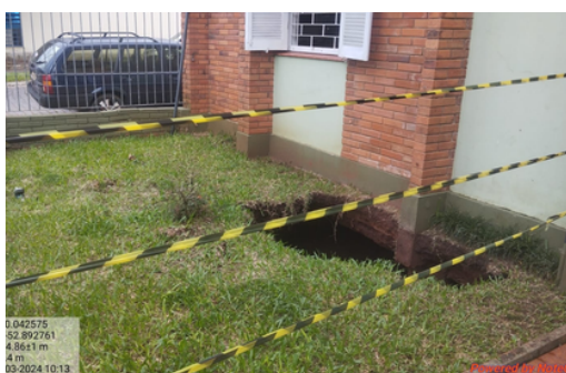
Isolamento de área de risco
