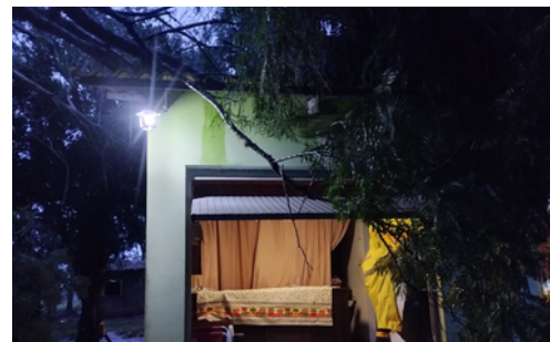
Destelhamento de residência perímetro urbano.
