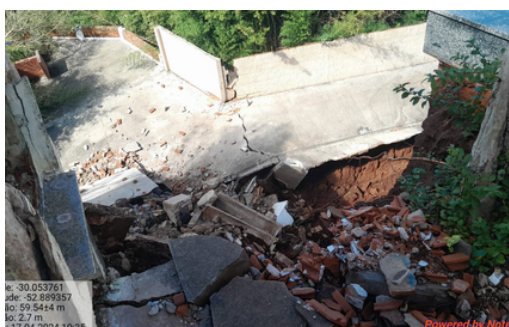
Deslizamento de terra Cemitério,
