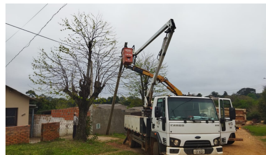
Retirada preventiva de poste com risco de queda sobre residência
