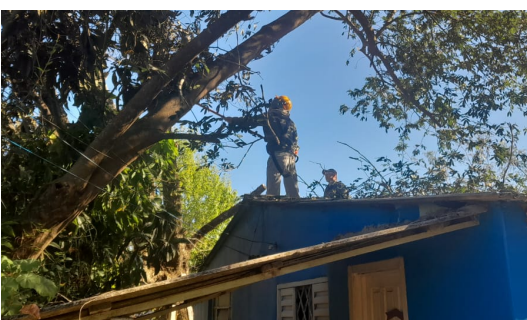
Retirada de árvore caída sobre residência
